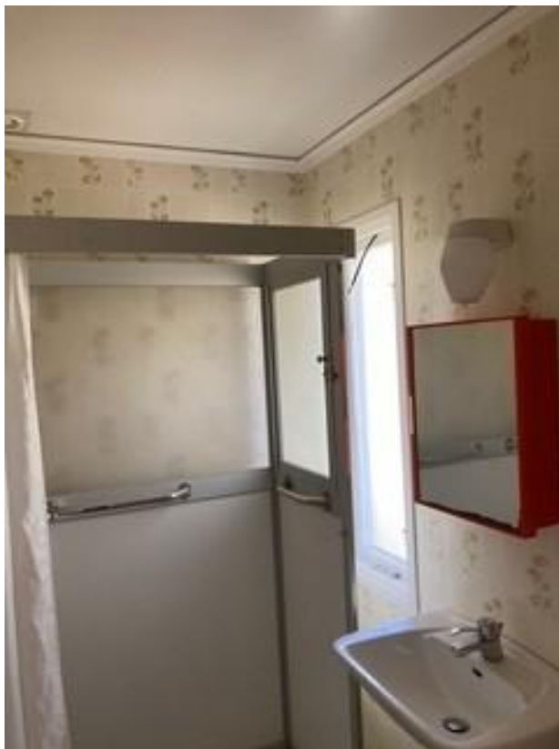
Bild 4. Dusch och tvättställ
