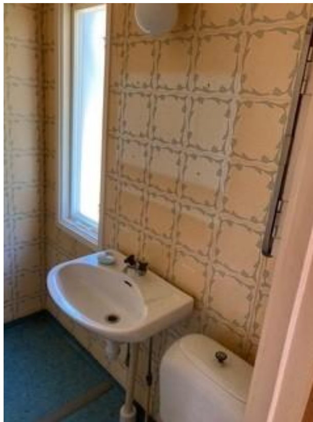
Bild 5. Tvättställ och toalett
