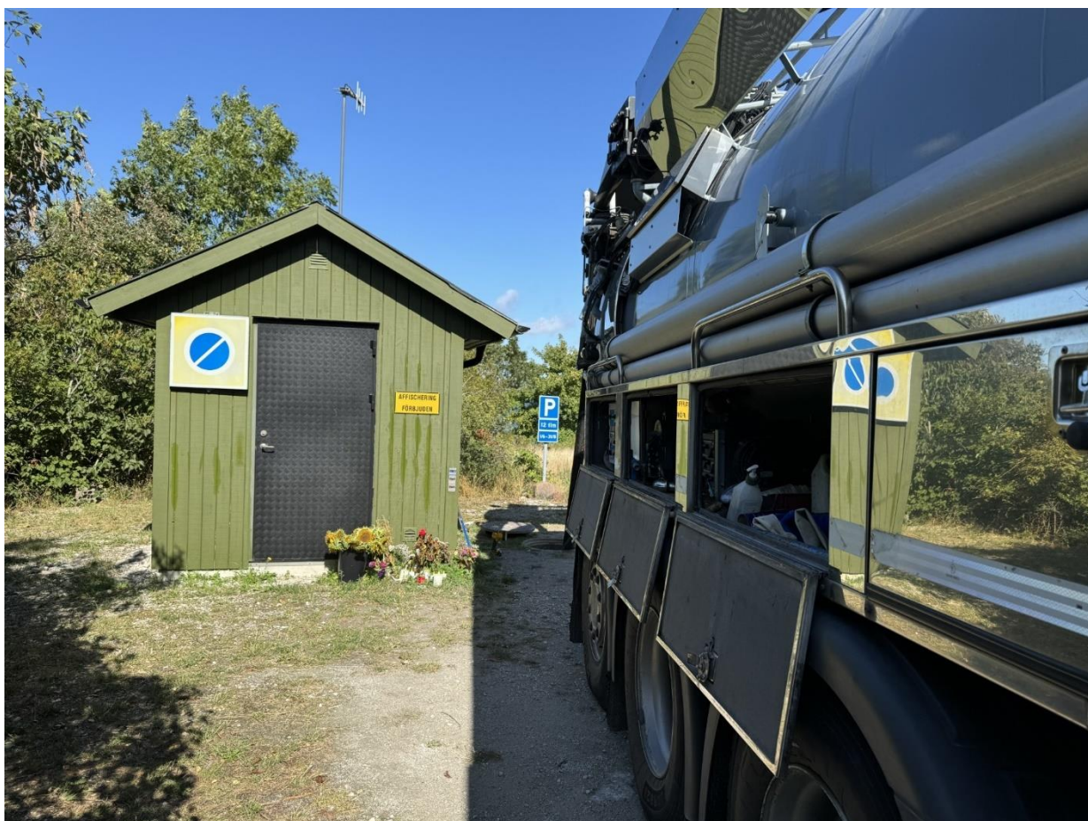
Pumpstationen sedd från spolbilens högra sida. Spolbil YAC 353 står uppställd som vid olyckstillfället.
