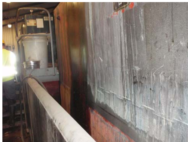
Foto: Förvaring s.k. malhjälpmiddel, inomhus och invallat i cisterner av stål.
