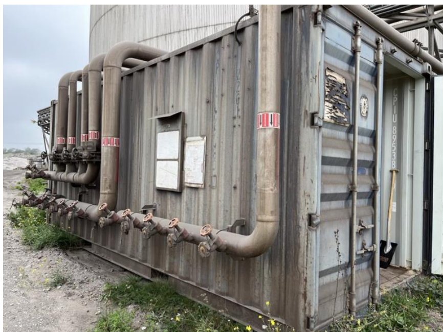
Figur 14. Skumanläggning och brandpost.
