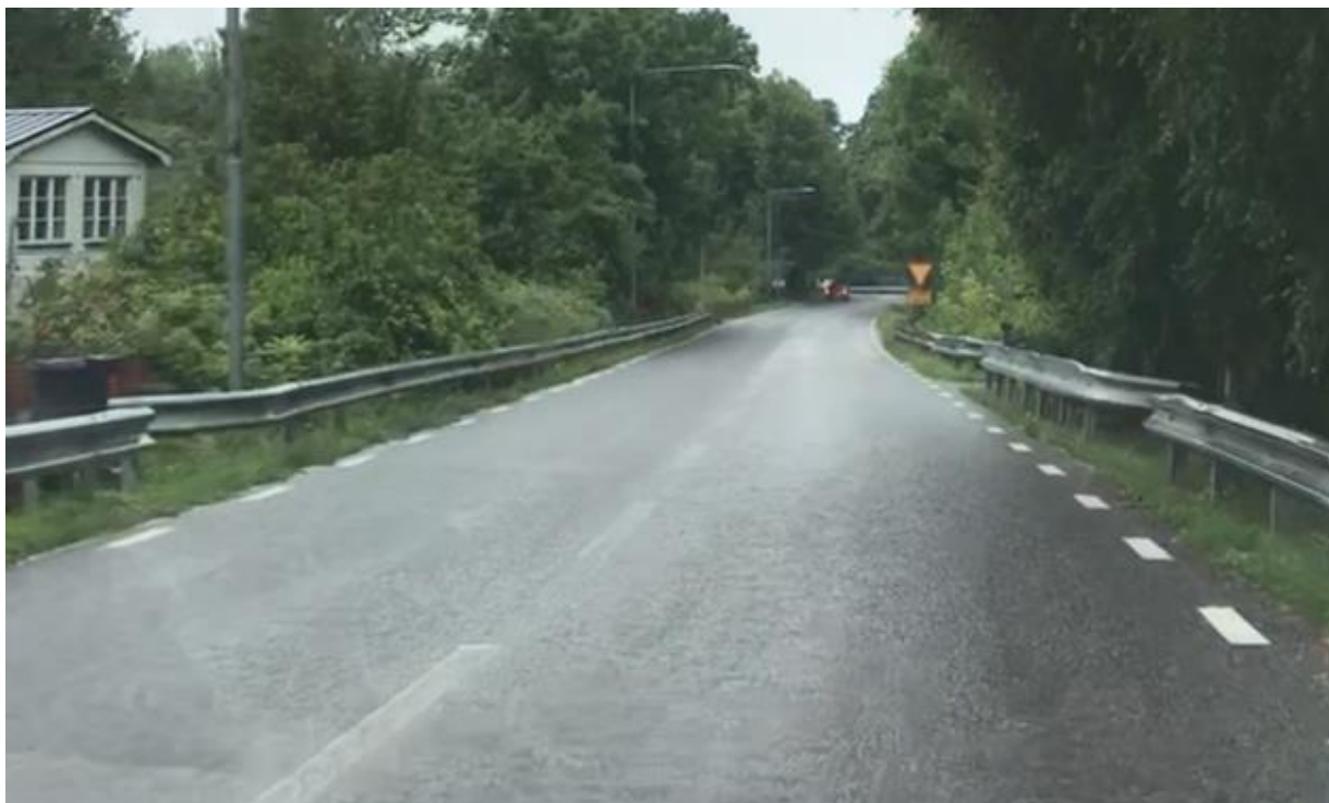
Figur 26. Bönders backe på väg 141 med påkörda vägräcken.
