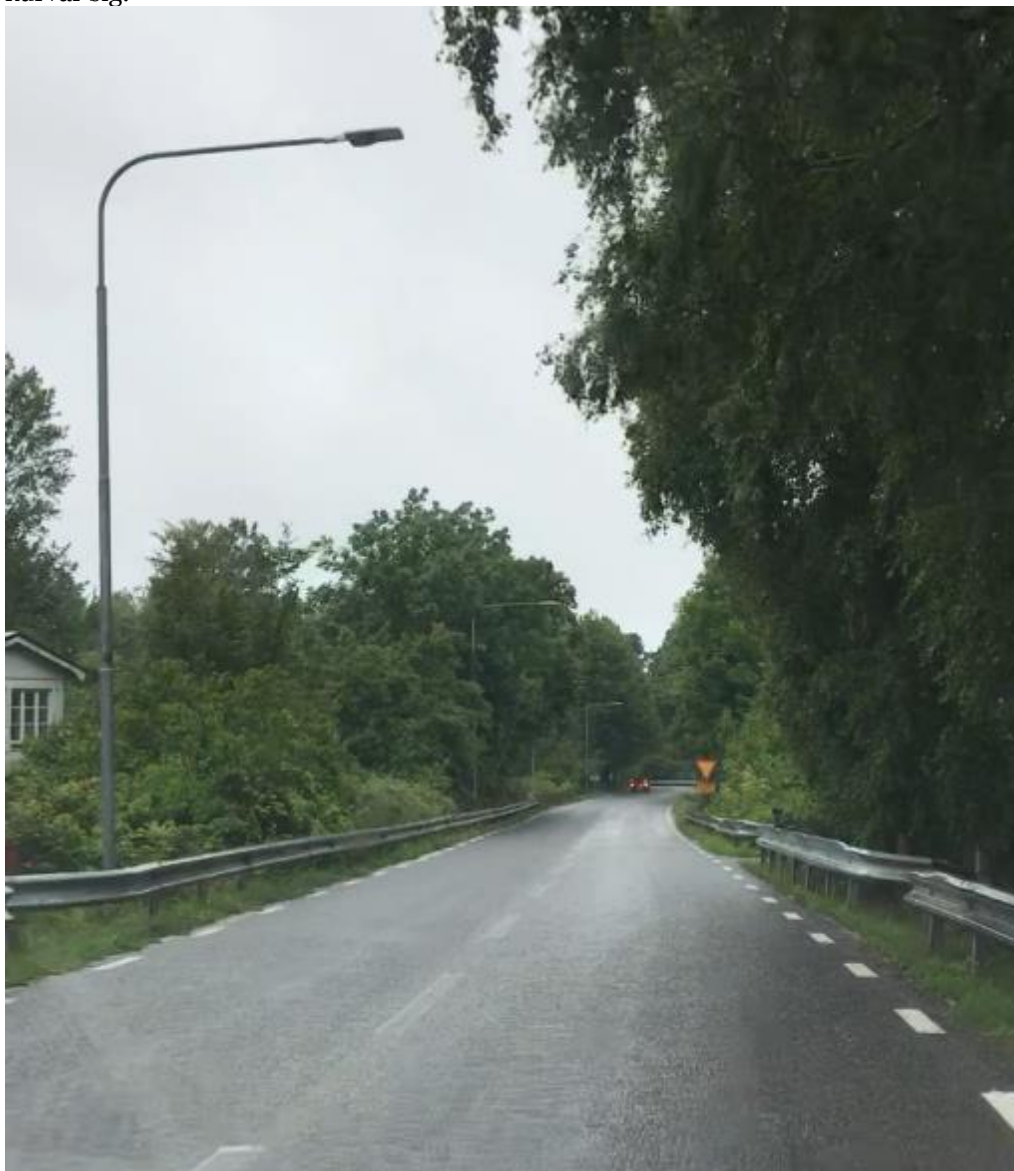
Figur 13. Väg 141 österifrån, i bilden noteras påkörda vägräcken.
