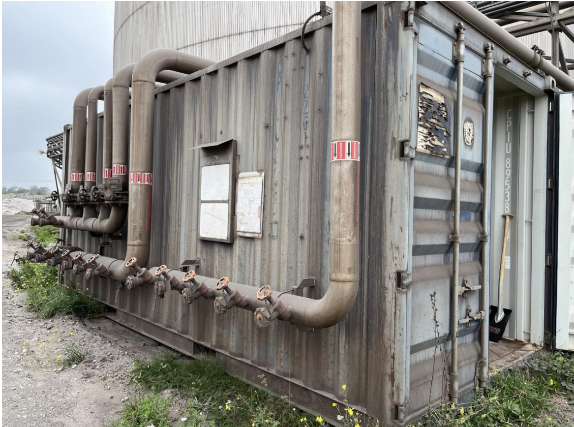
Figur 17-2 Skumanläggning och brandpost.
