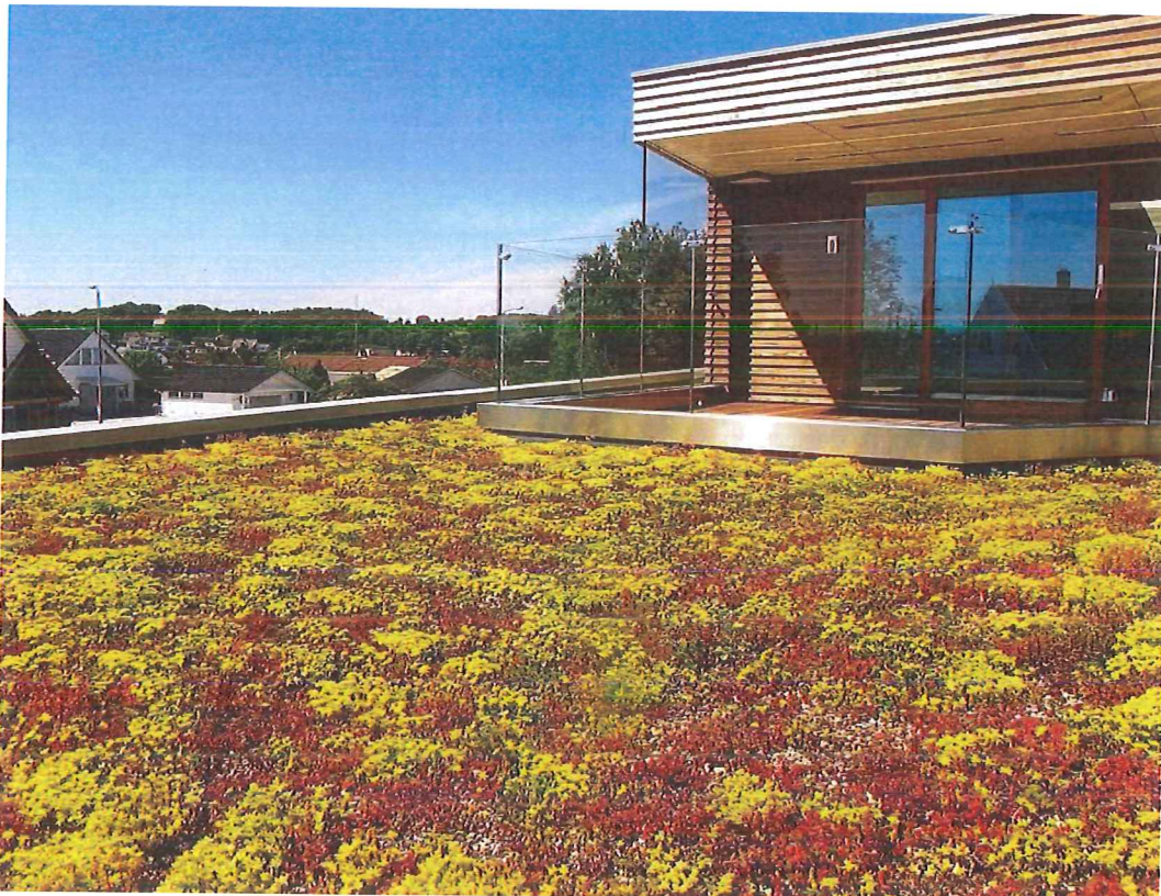
Figur 4 Gröna tak kan bidra till biologisk mångfald, utgöra en viktig del av det ekologiska samspelet, sänka temperaturen lokalt och reducera dagvattenmängder.
