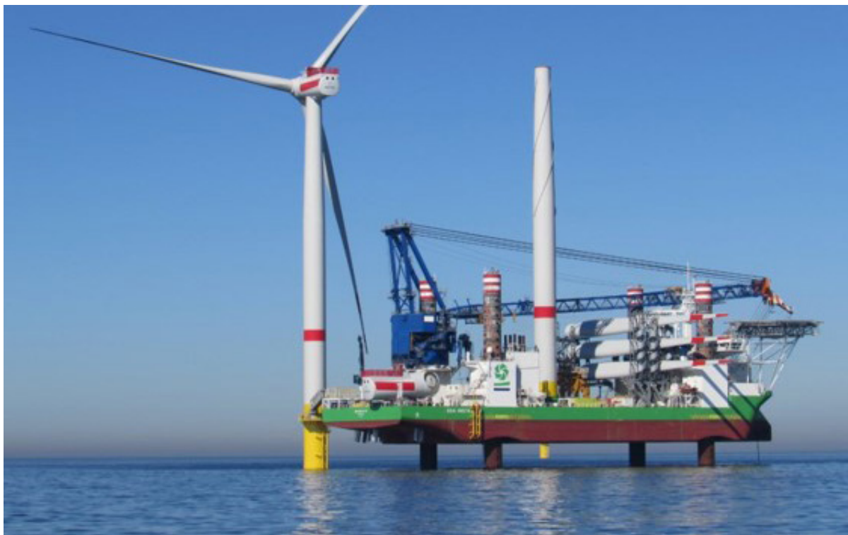
Figur 6. Montering av vindkraftverk med ett fartyg av typen stödbensplattform (jack-up). Källa: COWI
